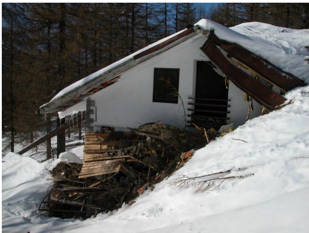
Figura 2.6 - Danneggiamento di un edificio. Sono evidenti i danni alla copertura, alle sue parti sporgenti e il deposito valanghivo sulla falda di monte. Ceresole Reale, Piemonte (Chiambretti, 2009).
